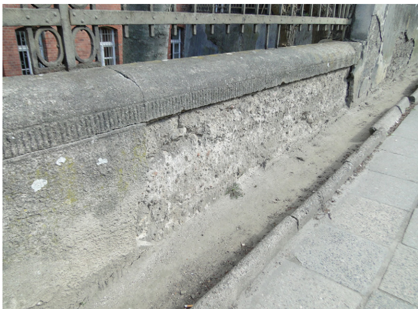
2. Ogródzenie szkoły, Szczecin, ul. Jagiellońska, stan części betonowych przed remontem i renowacją, stan z 2017 r. Fot. A. Hamberg-Federowicz.
