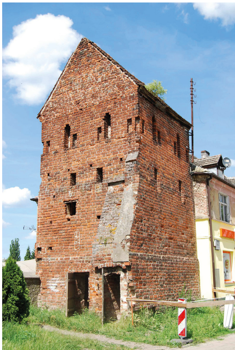
2. Baszta Więzienna, elewacje zachodnia i południowa, stan przed remontem. Fot. z archiwum WUOZ w Szczecinie.
