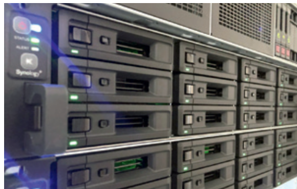
Serwery w Centrali PŻB S.A. w Kołobrzegu w 2019 roku.
